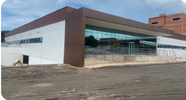
Seguindo o cronograma executivo das obras, a previsão é que a Unidade Avançada Unimed – Serra entre em funcionamento em 2024
