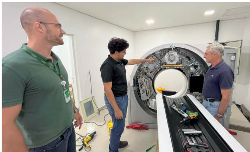
Diretor Presidente, Dr. Valério Delamanha, acompanhando a instalação do novo equipamento de tomografia.
